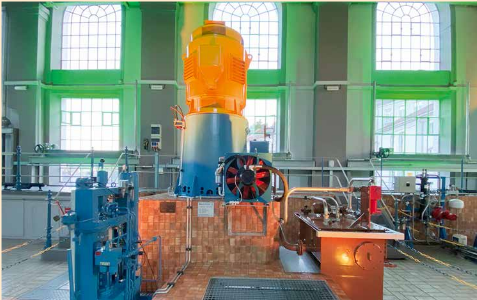
Blick in das Turbinenhaus auf die Francisturbine (Maschine 3) mit animiertem Licht
