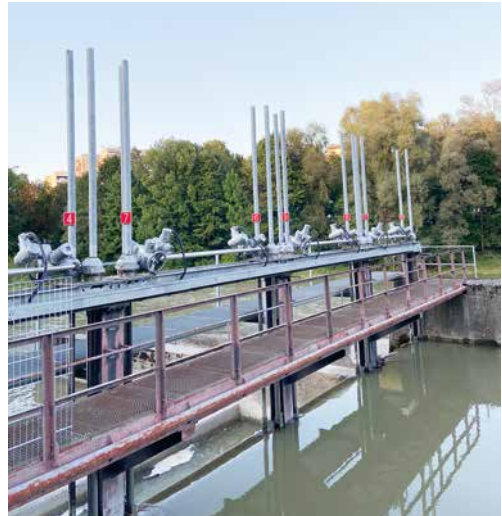
Die Stellantriebe wurden vor einigen Jahren erneuert.
