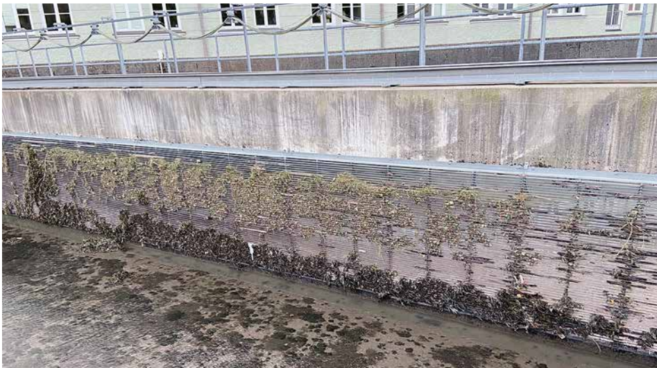
Das Einlaufbecken mit Blick auf den Feinrechen.
